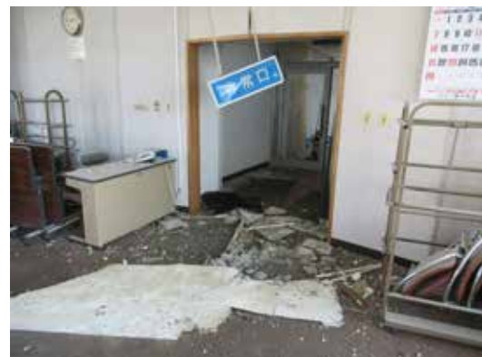
壊滅的な被害を受けた大会議室
