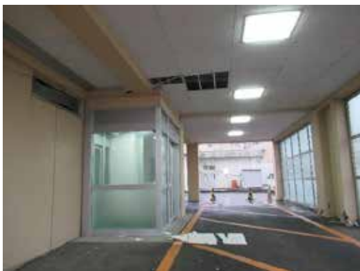
柱が損壊した救急外来
